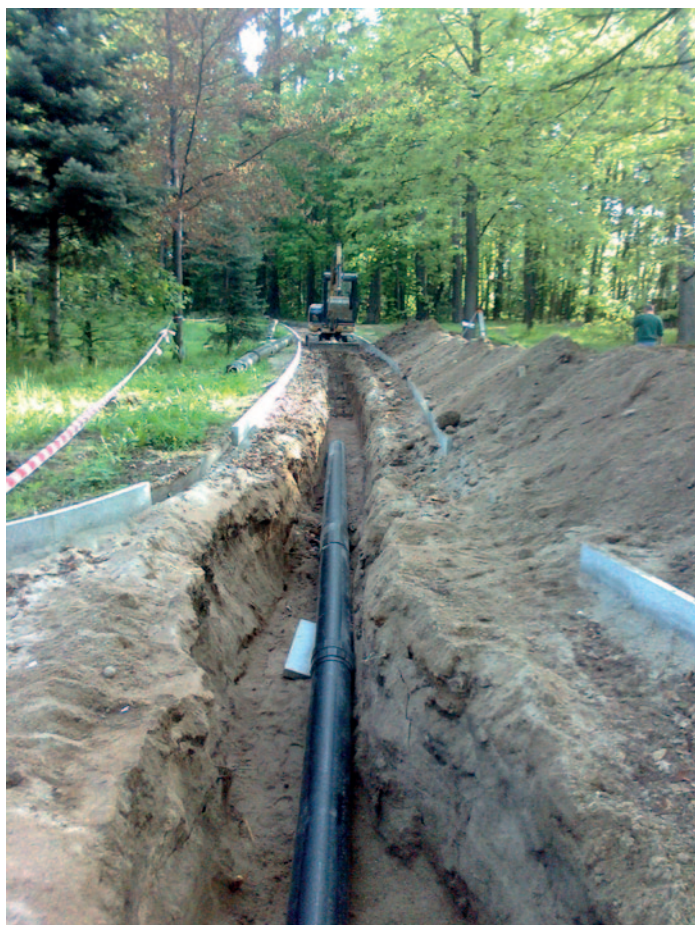
Prowadzenie rurociągu na terenie górzystym (rurociąg wody geotermalnej, Cieplice)
